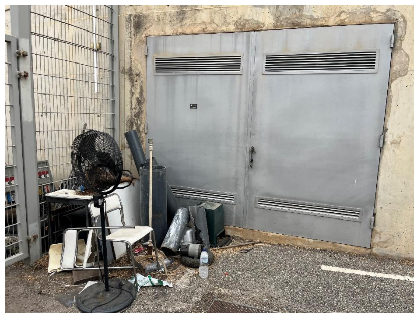
Exemplo de um Posto de Transformação sem identificação de sinal de perigo e com acesso obstruído
