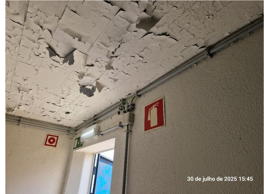
Exemplo de um Posto de Transformação com indícios de humidade
