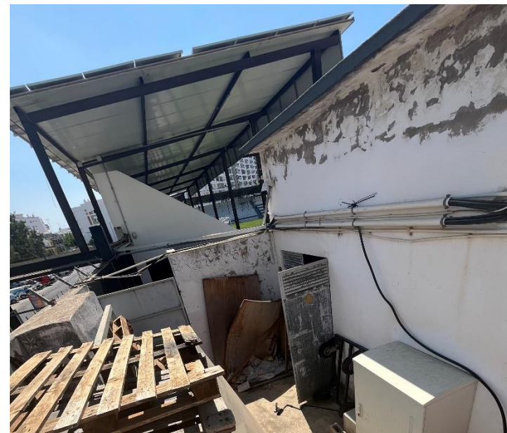
Exemplo de um Posto de Transformação com acesso obstruído
