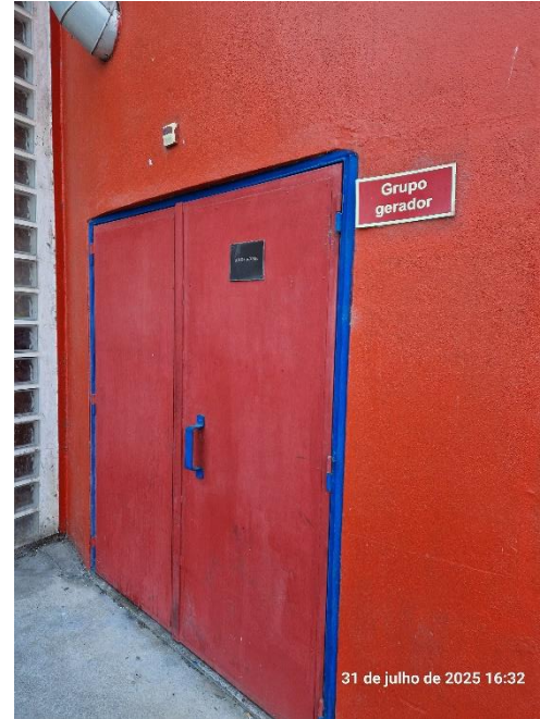
Ausência da sinalética de perigo de morte no edifício do grupo Gerador
