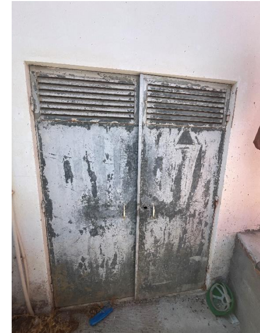
Sinalética de perigo danificada
