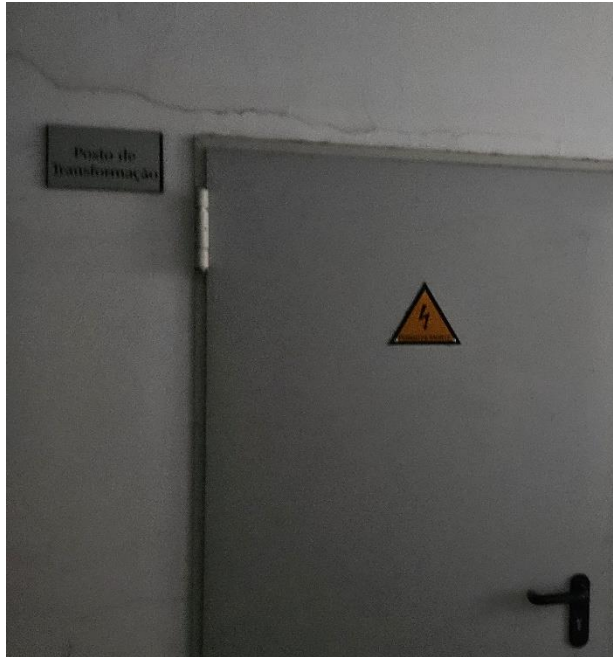
Identificação de perigo no Posto de Transformação
